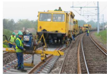
Longs Rails soudés sur traverses béton
